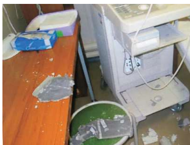
10月23日は長岡中央総合病院救急当番日でした 医療機器にも天井からの破損物が落ちてきた!!
