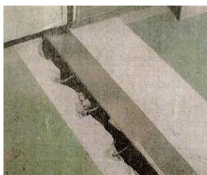
新館5階(前病院)の廊下の分離
