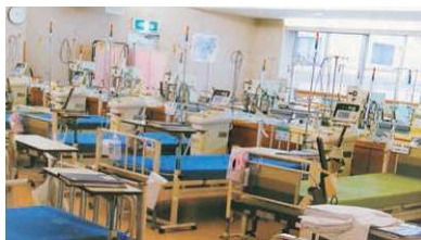
配管が損傷し、透析センターが水浸し
