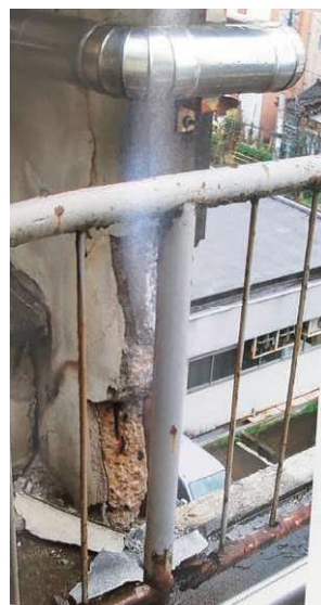
長岡中央総合病院の破損部分 外壁
